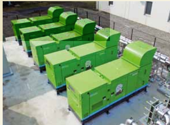
▲50kW×5台による高効率出力運転が可能
